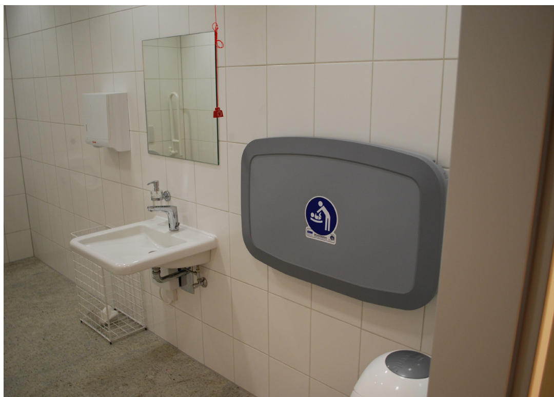
Zdjęcie nr 30 Sanitariat
