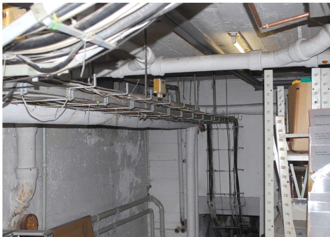
Zdjęcie nr 16 Instalacje wewnątrz budynku
