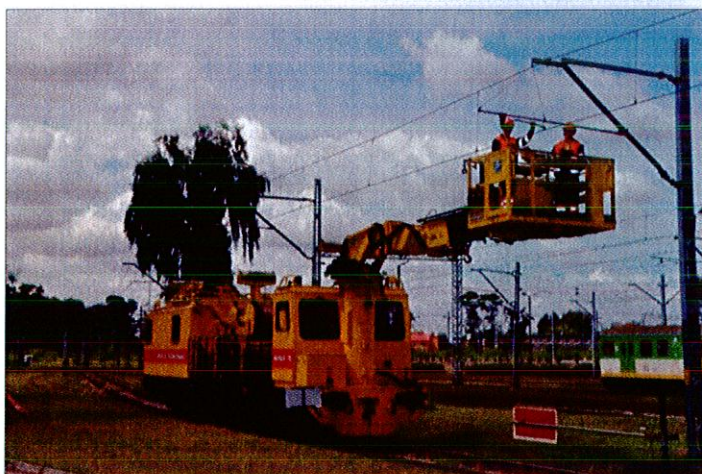
(Zdjęcie pozyskano w ramach kontroli NIK)
