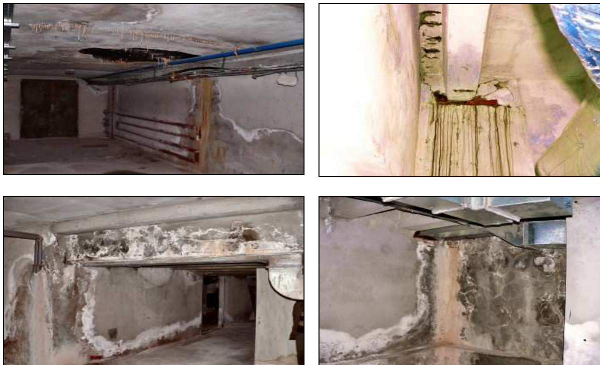
Rys. 17. Uszkodzenia niezabezpieczonych elementów budynków Centrum Kliniczno-Dydaktyczne w Łodzi.
