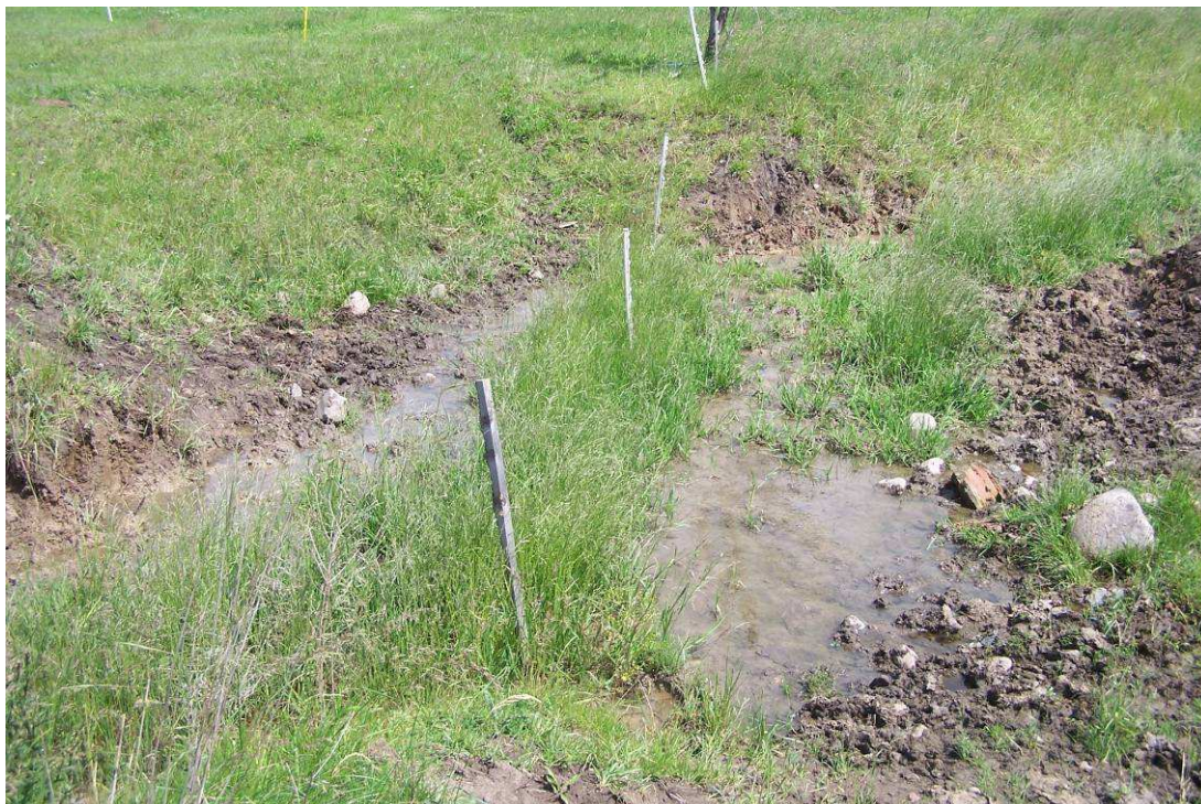
Fotografia nr 34. Zniszczony przez zwierzęta fragment rowu melioracyjnego RA6 na Obieckie Grodzisk Makarki z lat 1990-2004 (obręb Rybałty), gmina Grodzisk, powiat siemiatycki, na terenie działania GSW „Grodzisk” w Grodzisku
