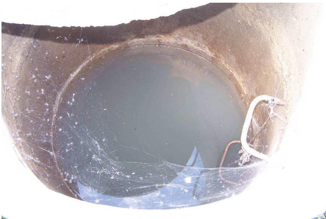
Fotografia nr 33. Zatkana studzienka drenarska na działce 57 (zbieracze poniżej poziomu wody), na obiekcie Grodzisk Makarki z lat 1990-2004 (obręb Aleksandrowo), gmina Grodzisk, powiat siemiatycki, teren działania GSW „Grodzisk” w Grodzisku
