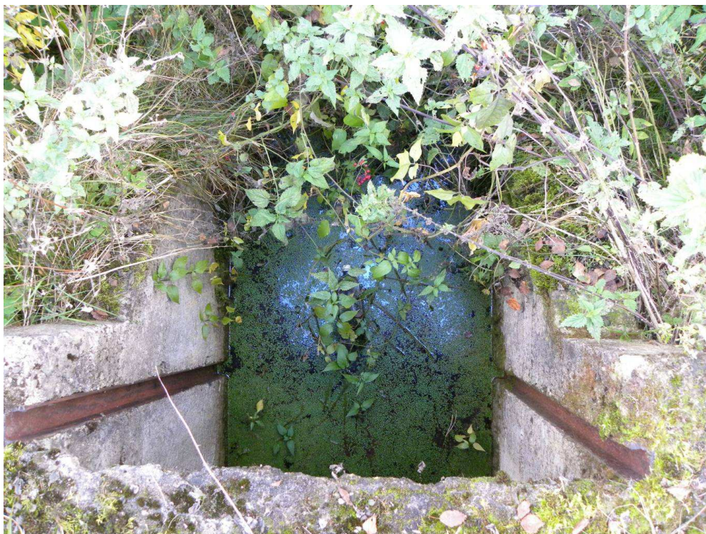
Fotografia nr 18. Zniszczona przepusto-zastawka na obiekcie Supraślanka z lat 1965 i 1973-1976 (obręb Jurówce), gmina Wasilków, powiat białostocki, na terenie działania GSW „Supraślanka” w Wasilkowie
