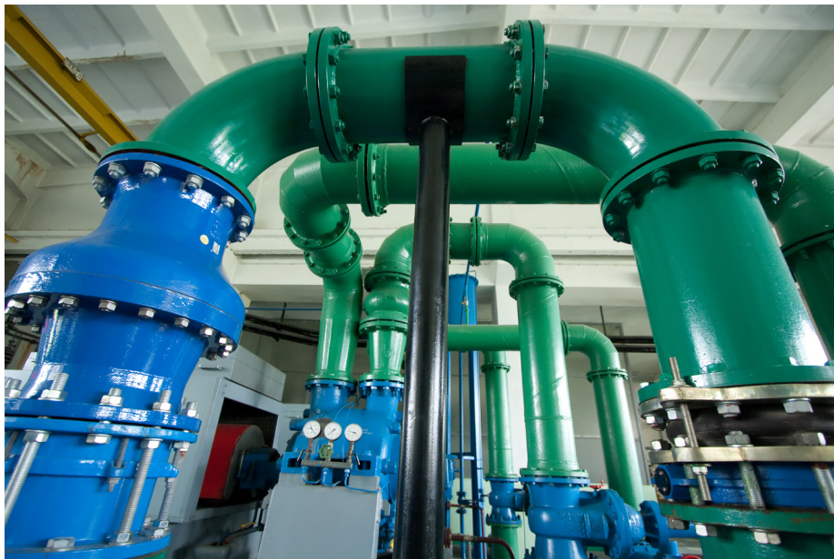
Zdjęcie nr 1 Hala pomp
