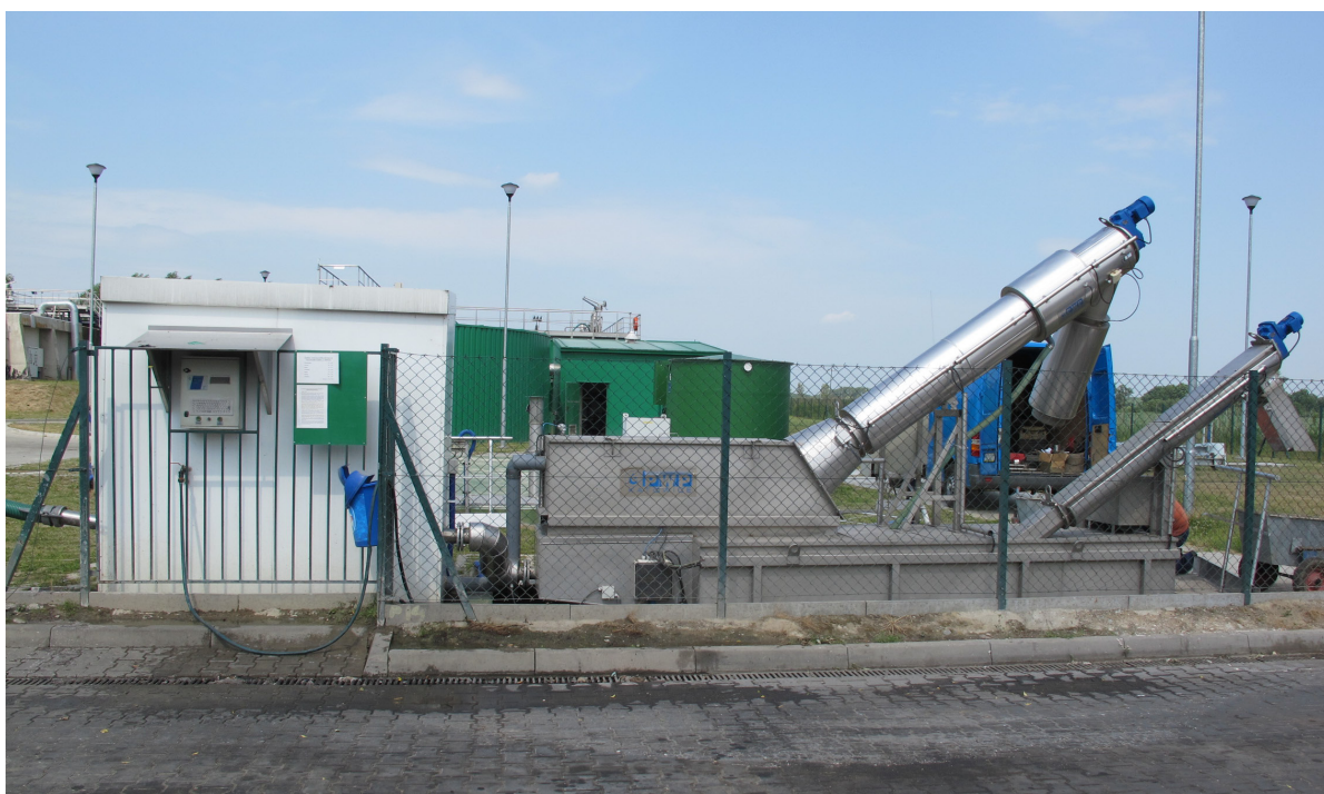
Zdjęcie nr 16 – Stanowisko zlewne ścieków dowożonych z sitem i piaskownikiem
