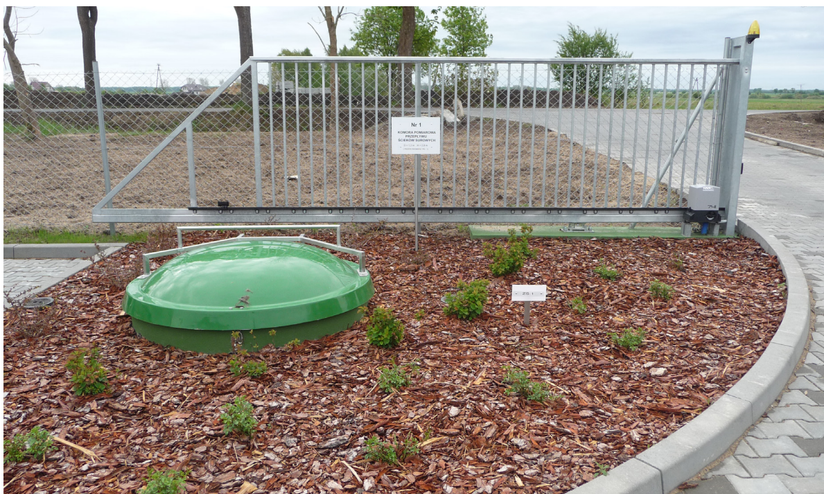
Zdjęcie nr 5 – Komora pomiarowa przepływu ścieków
