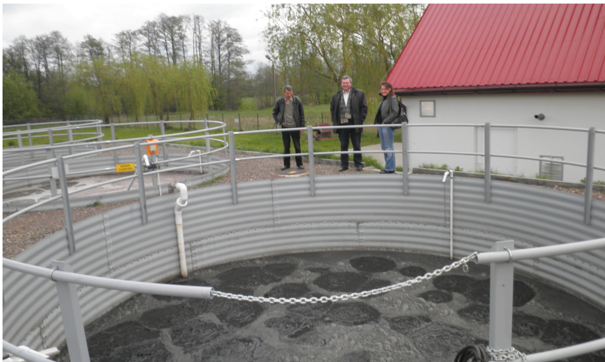
Zdjęcie nr 1 – Zbiorniki oczyszczalni ścieków wraz z budynkiem socjalno-technicznym
