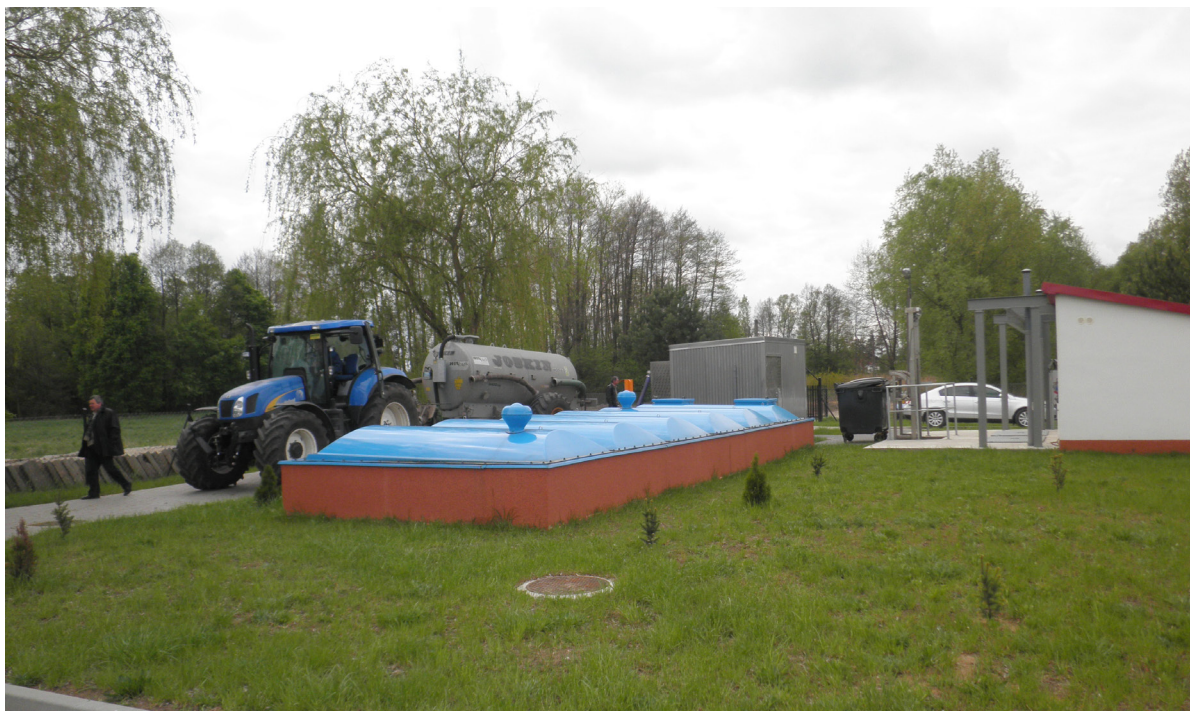
Zdjęcie nr 3 – Stacja zlewcza – oczyszczalni ścieków
