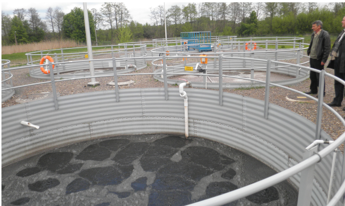
Zdjęcie nr 2 – Zbiorniki oczyszczalni ścieków
