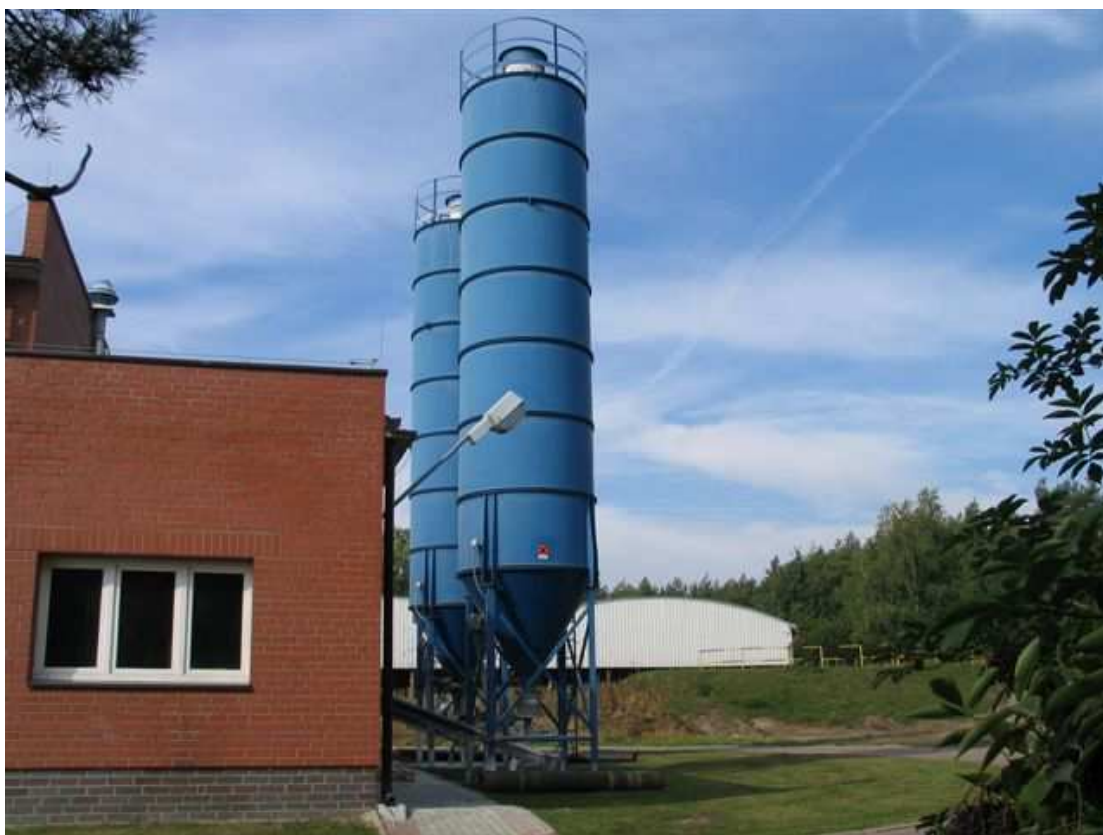
Fotografia nr 4. Silosy z wapnem do higienizacji osadów .
