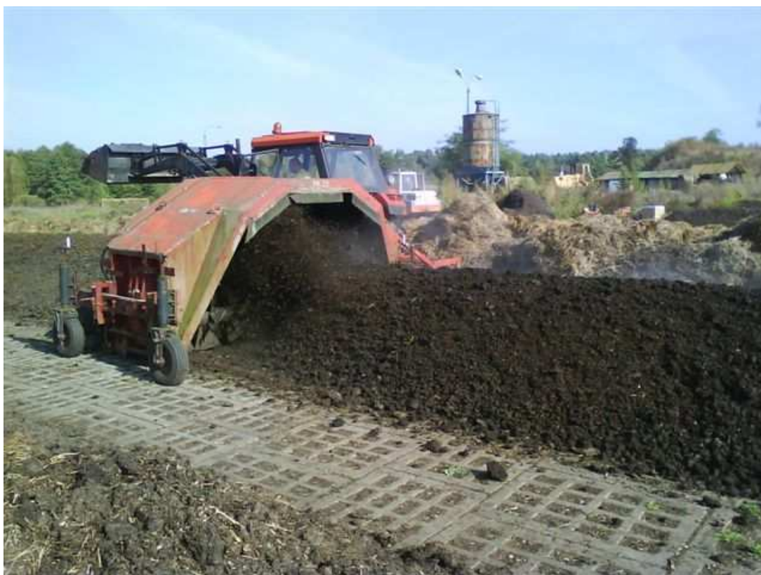
Fotografia nr 2. Napowietrzanie osadów .
