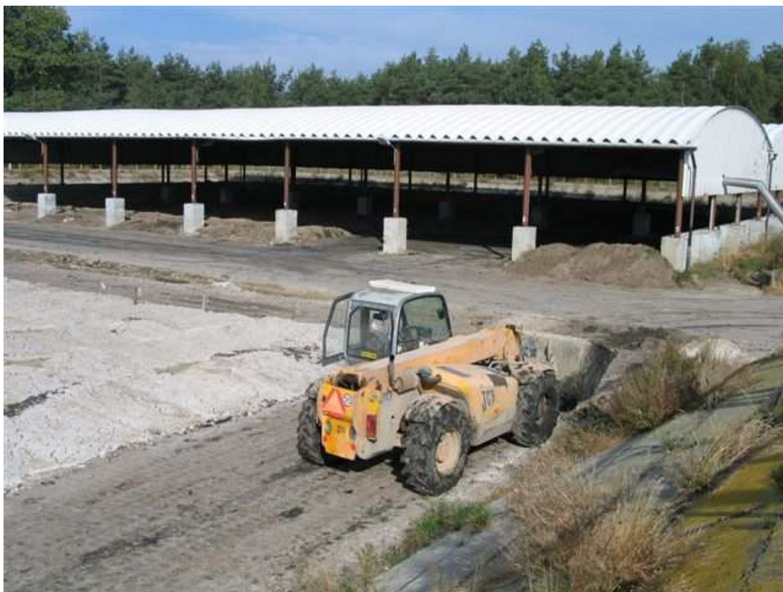
Fotografia nr 3. Poletka osadowe i przygotowywanie osadów do wywiezienia.
