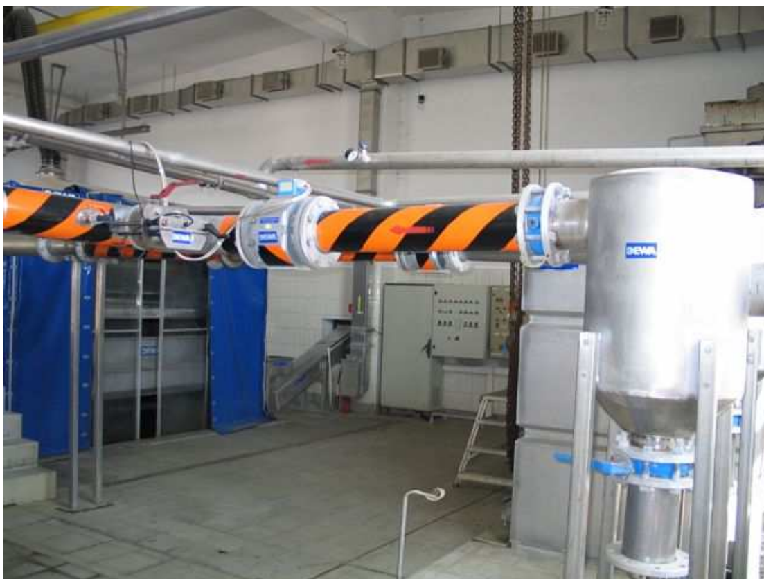
Fotografia nr 7. Urządzenia oczyszczalni do przeróbki osadów.
