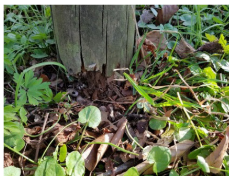
Zmurszały słupek konstrukcyjny
