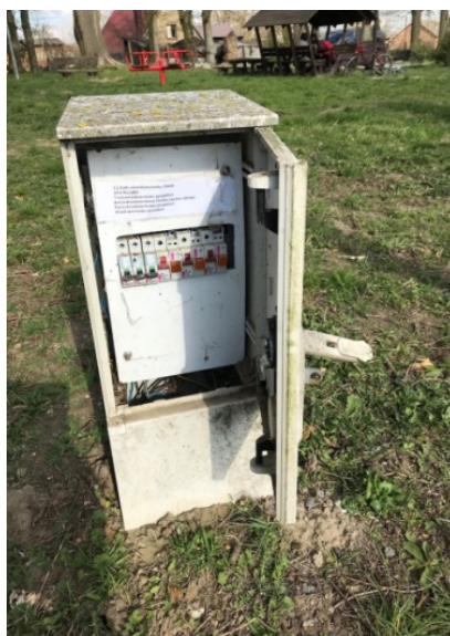
Niebezpieczna skrzynka elektryczna
