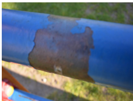
Niezabezpieczone elementy i korozja szczelbli drabinki
