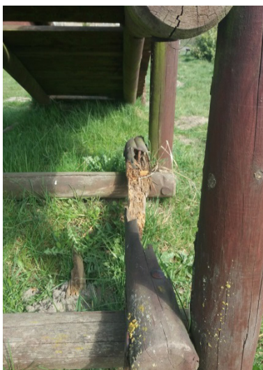
Spróchniałe belki konstrukcji i podestu zjeżdżalni
