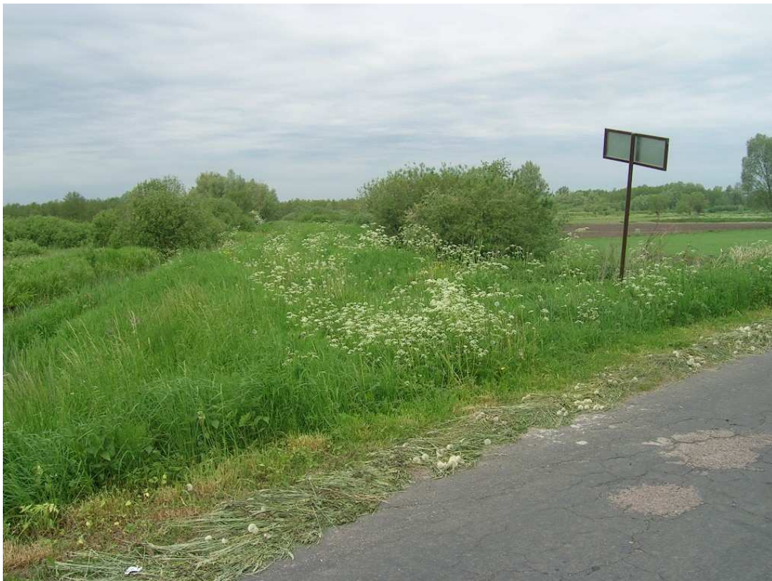
Fragment nieokoszonej skarpy i korony wału czołowego jez. Družno na polderze Nr 70 w m. Węzina (gm. Elbląg), o dług. 1,36 km, szer. korony 3,0 m i wysokości 2,0 m.
