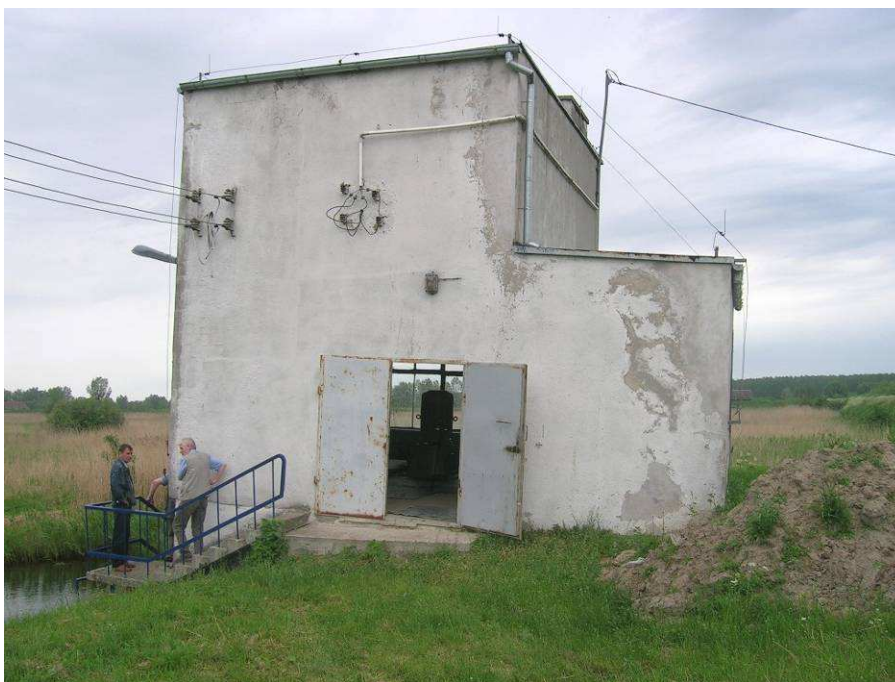
Stacja pomp nr 76 w miejscowości Nowe Dolno (gm. Markusy), odwadniająca 1,1 tys. ha. Budynek odchylony od pionu o ok. 30 cm. ŻZM i UW w Elblągu posiada projekt przebudowy stacji kosztem około 800 tys. zł, zatwierdzony decyzją o pozwoleniu na budowę oraz pozwolenie wodno-prawne. Projekt ten uwzględnia m.in. zastosowanie nowoczesnych, energooszczędnych agregatów pompowych.
