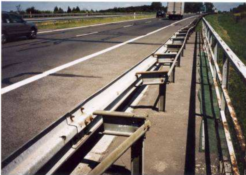
Fot. 13. Widok na uszkodzony odcinek bariery na obiekcie mostowym nr 45 zlokalizowanym w ciągu autostrady w rejonie miejscowości Zalas-Podlesie (brak taśmy tylnej oraz brak połączenia wysięgnika słupka z taśmą profilową). Widoczne zalanie rys nawierzchni jezdni. Skorodowana balustrada obiektu mostowy i widoczne uszkodzenia erozyjne gzymsu (zabezpieczone siatką) – widok wg stanu na czerwiec 2005 r.
