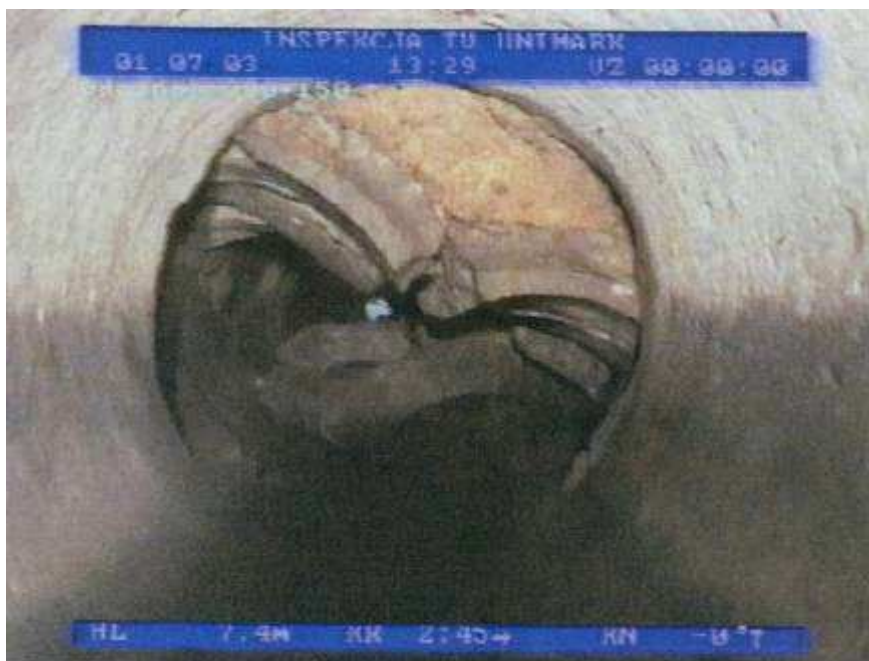
Fot. 11. Załamany kanał o średnicy 300 mm pod jezdnią autostrady w km 380+150, kierunek Kraków – widok wg stanu na czerwiec 2004 r. (uszkodzenie ujawnione podczas czyszczenia sieci kanalizacyjnej – monitoring kamerą telewizyjną).
