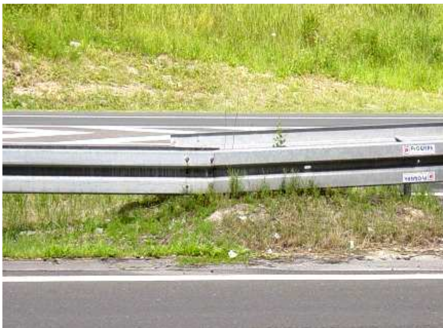
Fot. 17. Za nisko usytuowana bariera ochronna w km 400 + 900 (możliwość „przeskoczenia” pojazdu nad barierą) – widok wg stanu na czerwiec 2005 r.
