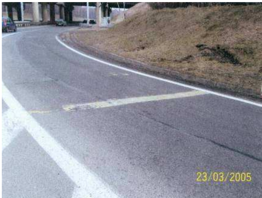
Fot. 19. Węzeł Murckowska – łącznica Warszawa-Kraków. Nieusunięta linia bezwzględnego zatrzymania się – znak P-20
