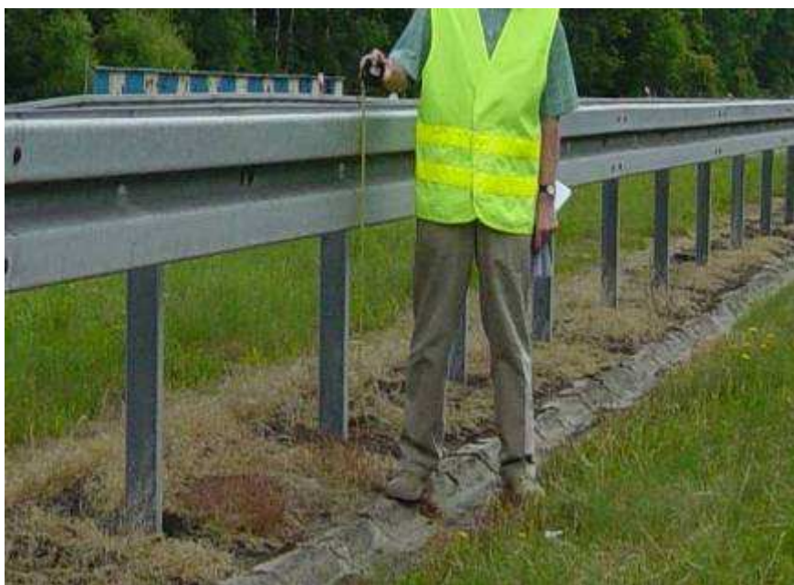
Fot. 18. Za wysoko usytuowana bariera ochronna w km 400 + 900 (możliwość wjechania pojazdu pod barierę ochronną) – widok wg stanu na czerwiec 2005r.
