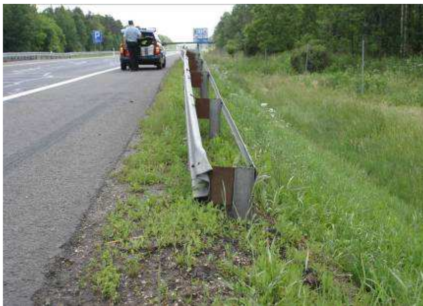
Fot. 16. Ostre zakończenie bariery – km 358 + 400 – widok wg stanu na czerwiec 2005 r.
