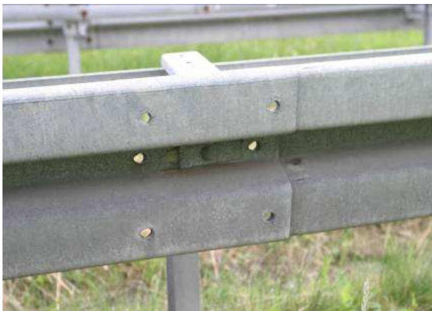
Fot. 14. Brak połączeń śrubowych taśmy profilowanej – km 371+ 600 – widok wg stanu na czerwiec 2005 r.
