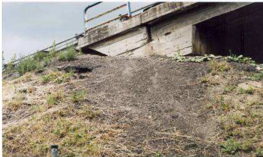
Fot. 8. Obiekt mostowy Nr 30 (zlokalizowany w ciągu autostrady – w rejonie miejscowości Chrzanów) – usuwający się grunt spod skrzydła i oczepu od strony Katowic – stan na czerwiec 2005 r.
