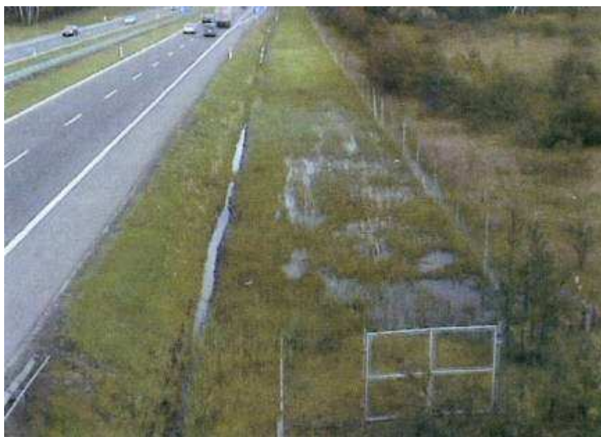
Fot. 12. Brak odpływu wód opadowych z rowu odwadniającego w km 361+500, kierunek Kraków (stan na czerwiec 2004 r.).
