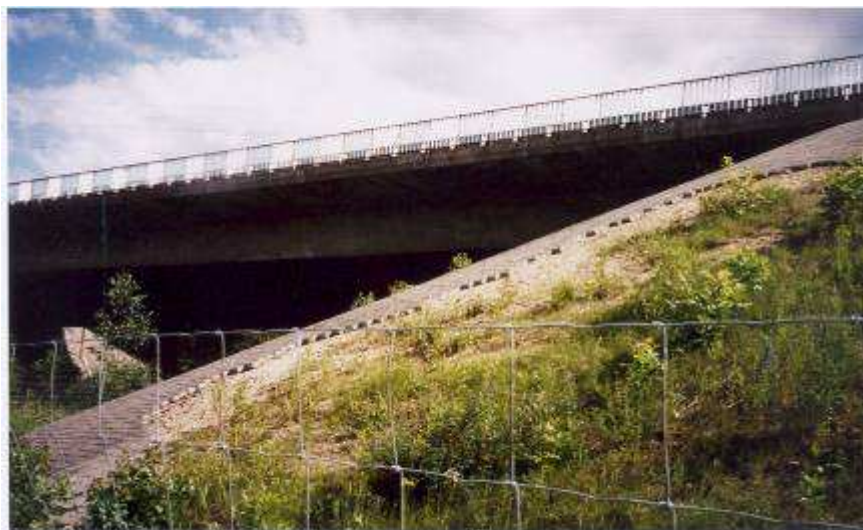
Fot. 7. Obiekt mostowy Nr 15 (zlokalizowany w ciągu autostrady – w rejonie miejscowości Dzieńkowice) - zniszczone zabezpieczenie stożka od strony Mysłowic – stan na czerwiec 2005 r.
