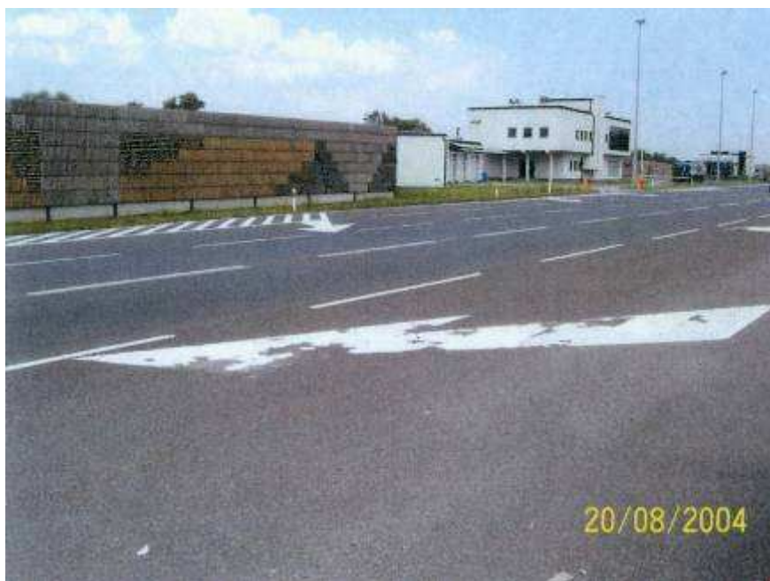
Fot. 20. Punkt Poboru Opłat Balice. Odrywająca się taśma oznakowania poziomego.
