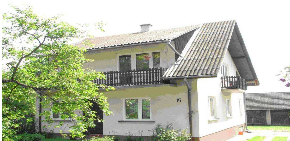
Fot. nr 2. Dach budynku jednorodzinnego w Biłgoraju pokryty płytami azbestowo-cementowymi.
