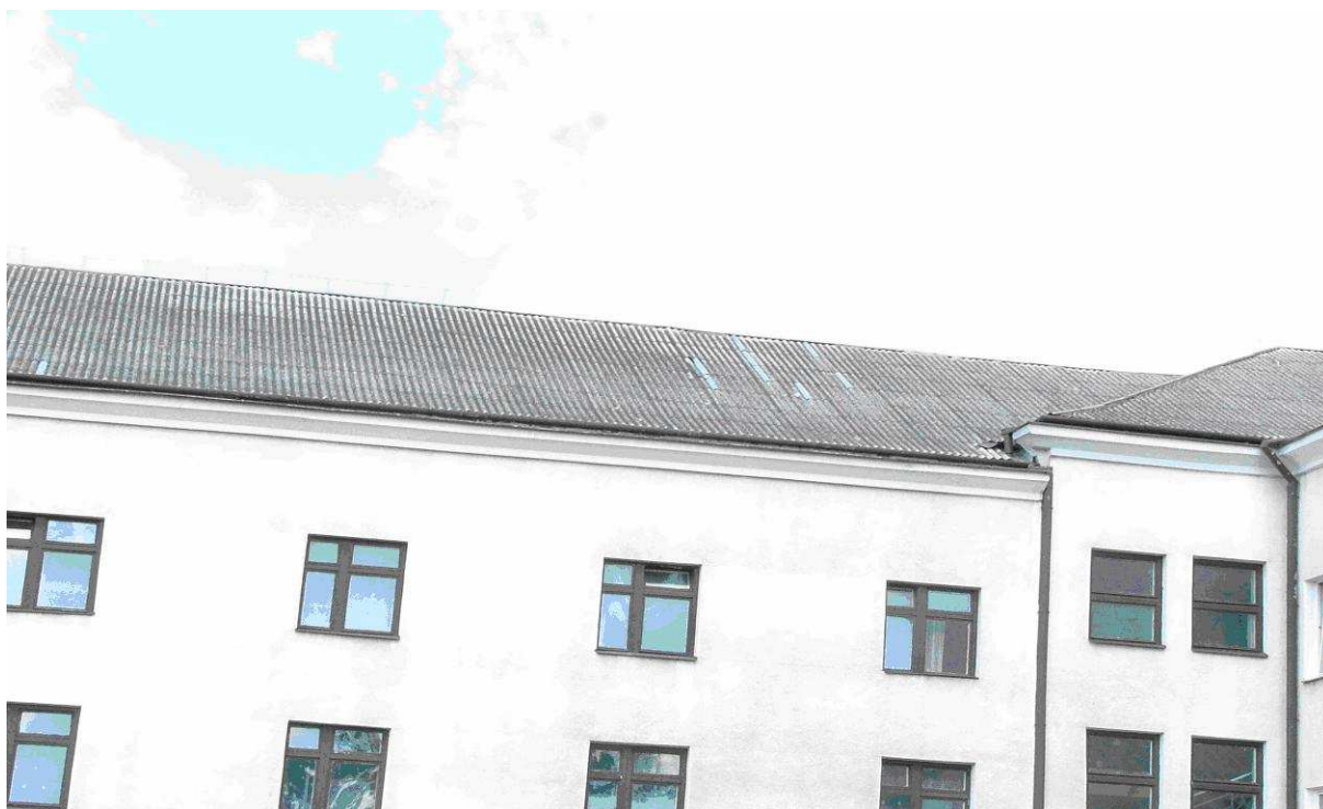
Foto Nr 3. Dach Kolegium Uniwersytetu - Marii Curie-Skłodowskiej w Lublinie (filia w Biłgoraju) pokryty płytami azbestowo cementowymi
