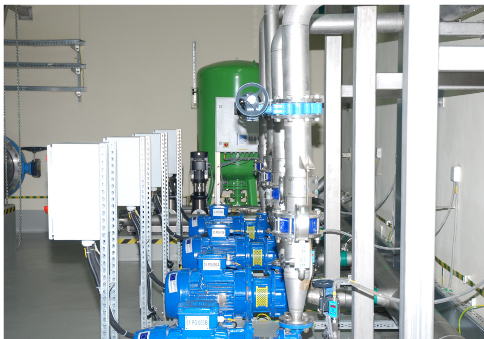
Zdjęcia nr 6 Stacja uzdatniania wody
