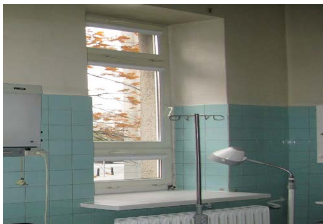
Niezasłonięte okna w gabinecie zabiegowym
