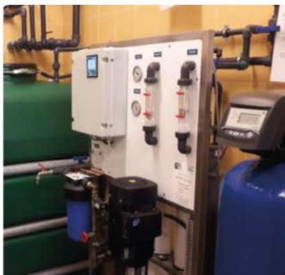
Stacja uzdatniania wody służąca zasilaniu sterylizatorów parowych i myjni-dezynfektorów
