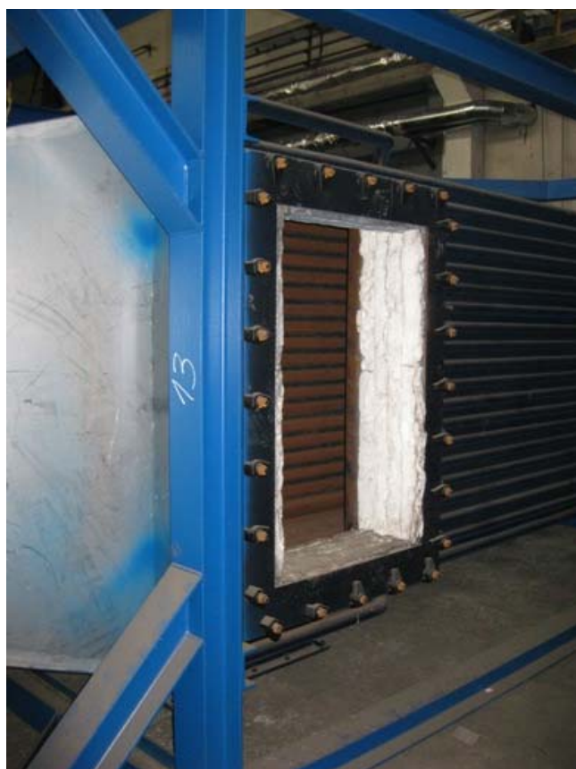
Kocioł na konstrukcji stalowej
