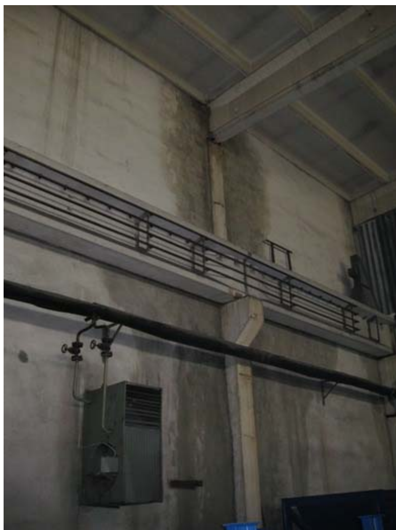
Hala magazynowa – widok na nagrzewnicę oraz na łączenie ścian i stropu (widoczne zacieki i zagrzybienie ściany)
